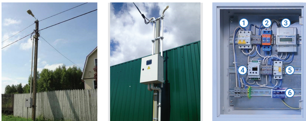
Рисунок 1 - Пример щита учёта на опоре
