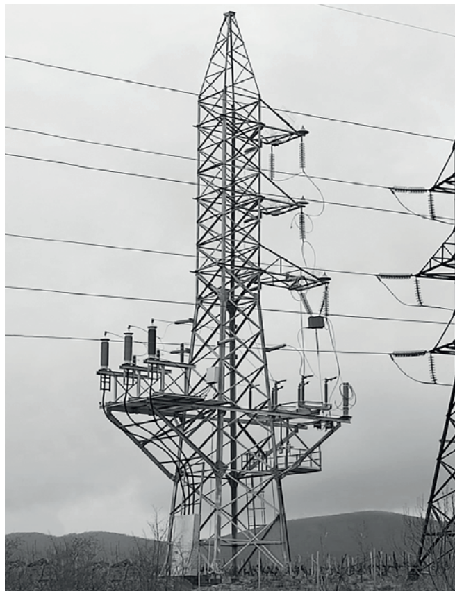
Переходной пункт ПКПО-АКЭП-110.2-2.1, отдельные эксплуатационные площадки для оборудования и приводов разъединителя, оборудование ВЧ-связи, г. Ростов-на-Дону
