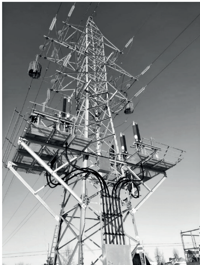
Переходной пункт ПКПО-АКЭП-110.2-2.1, эксплуатационные площадки для оборудования, оборудование ВЧ-связи, г. Воронеж
