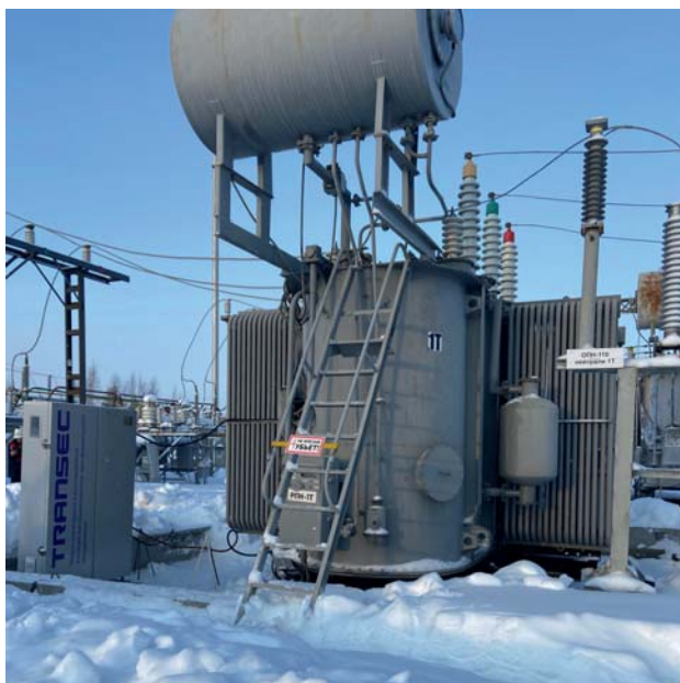
Рис. 1. Модуль TRANSEC, смонтированный на 1Т ПС 110/35/6 кВ «Омичка» (ТДТН-16000/110) филиала АО «Россети Тюмень» Когалымские электрические сети
