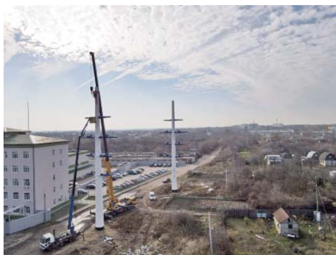
Рис. 2. Переходные пункты ПКПО-КВ-110.1-2.1 при организации кабельных отпайек КВЛ 110 кВ Дягилевская ТЭЦ — Развитие с отпайкой на ПС «Элеватор» и КВЛ 110 кВ Ямская — Развитие с отпайкой на ПС «Дашки» в Рязанской области
