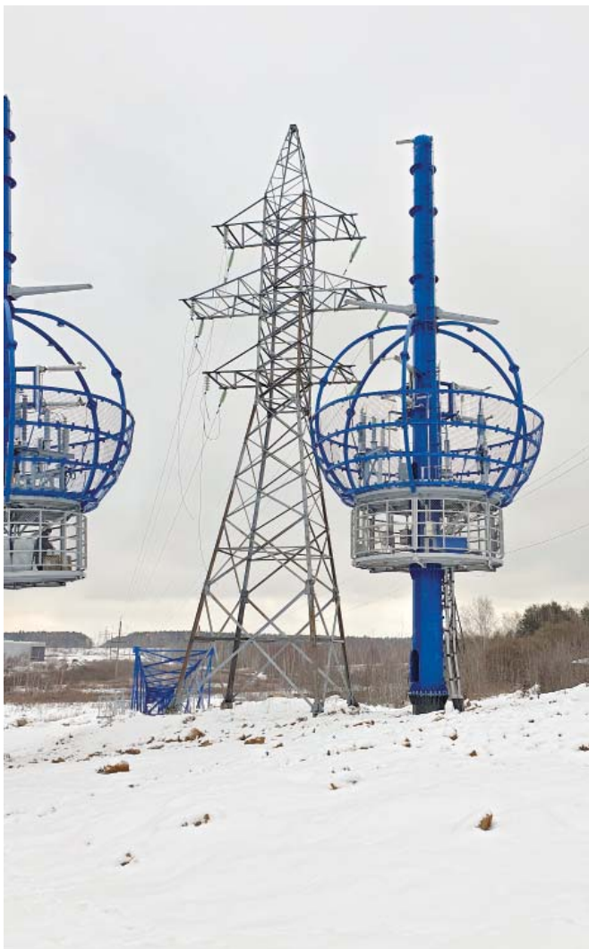
Рис. 3. Переходные пункты ППМ-110 кабельных заходов на ПС «Тютчево» и ПС «Пушкино» в Московской области
