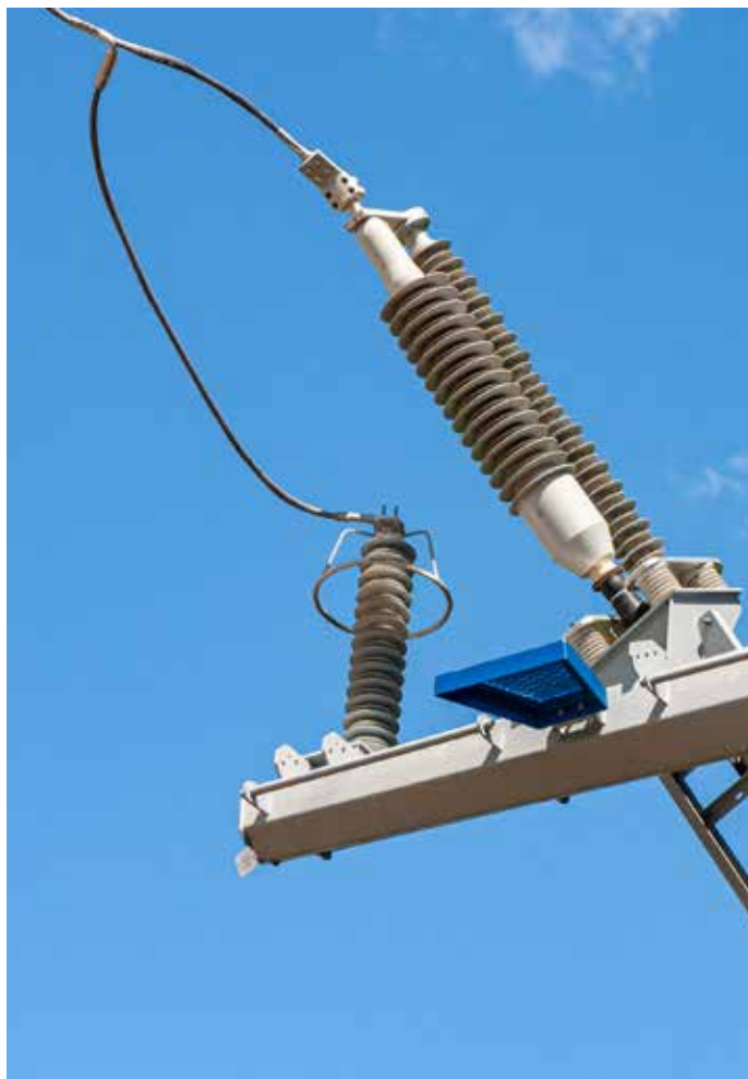
Сухие кабельные муфты с опорным изолятором на траверсе переходного пункта
