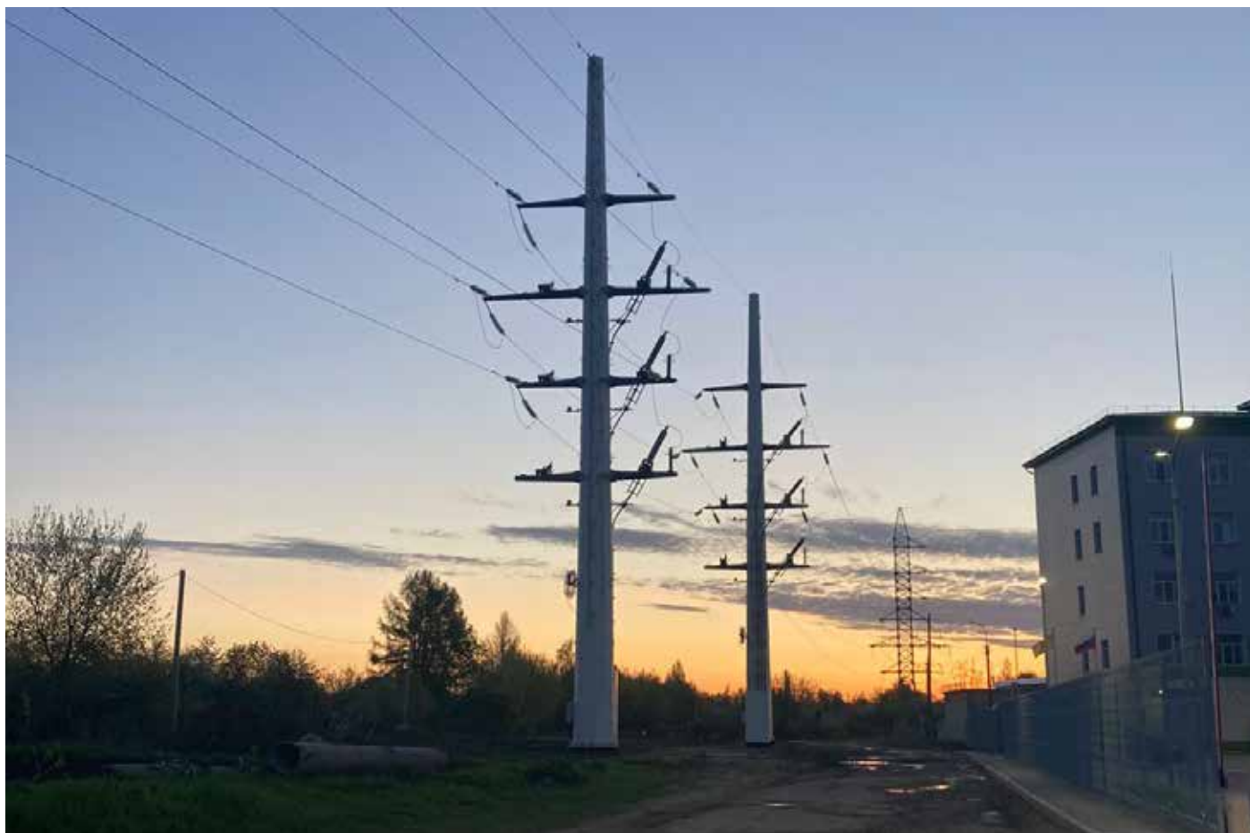
Кабельные отпайки от КВЛ 110 кВ Дягилевская ТЭЦ — Развитие с отпайкой на ПС Элеватор, КВЛ 110 кВ Ямская — Развитие с отпайкой на ПС Дашки, Рязанская область
