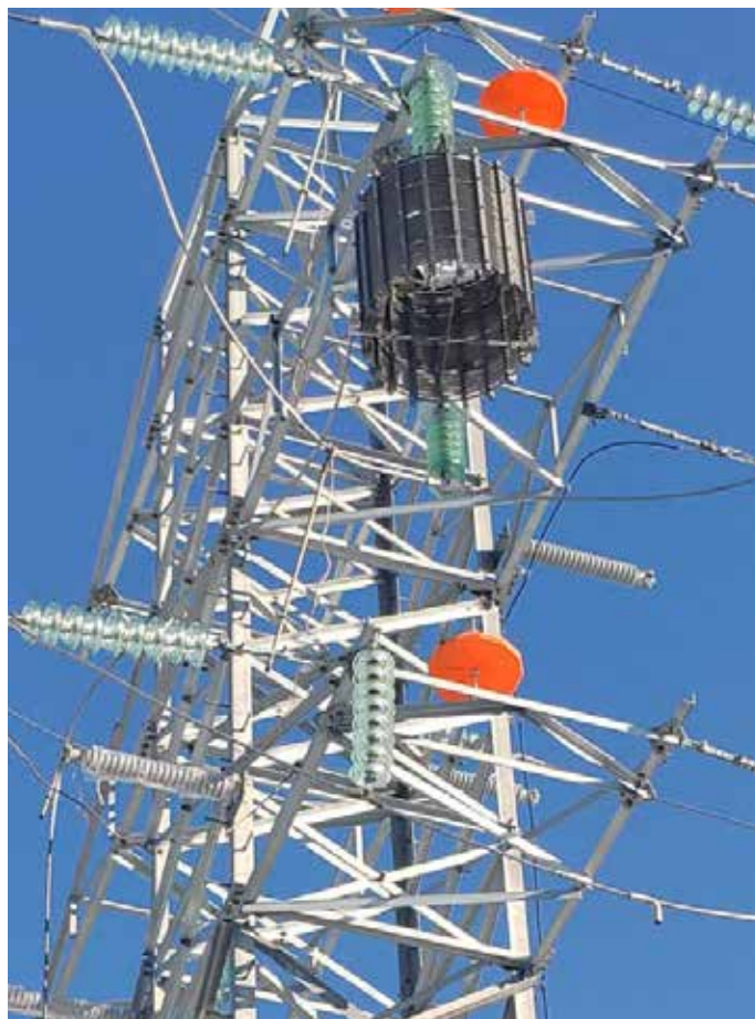
Высокочастотный заградитель, установленный на траверсе
