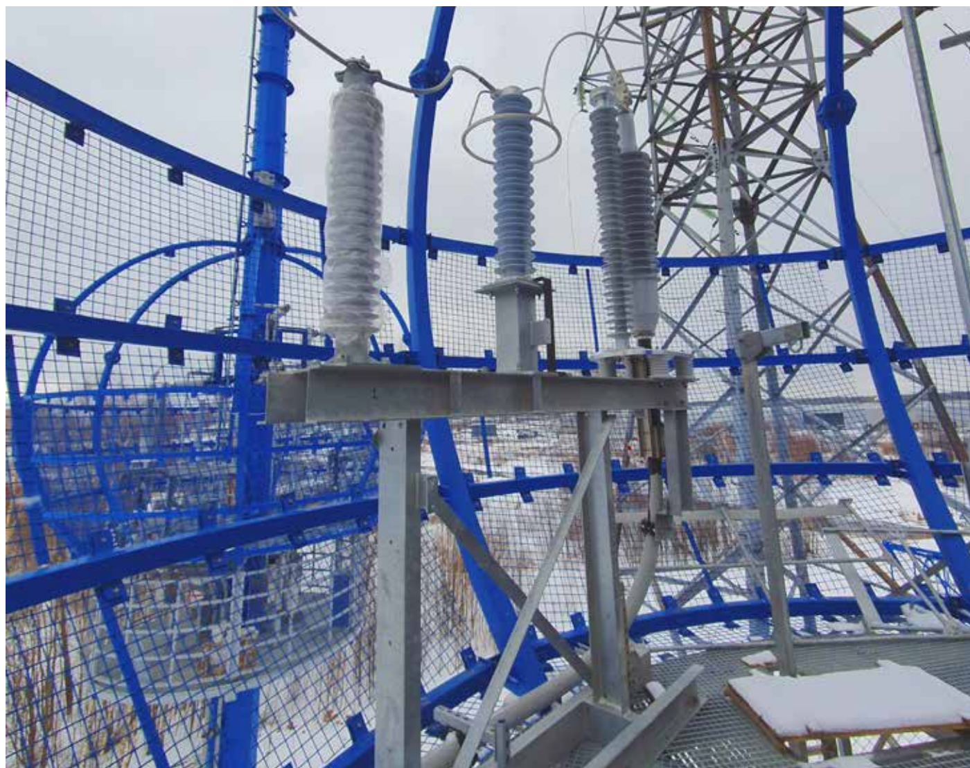
Основное оборудование: ОПН и концевая кабельная муфта с опорным изолятором
