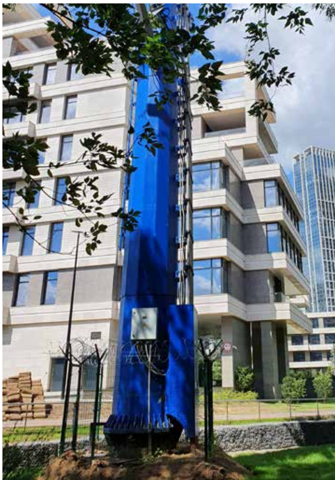
Ограждение переходного пункта и защитный кожух кабеля
