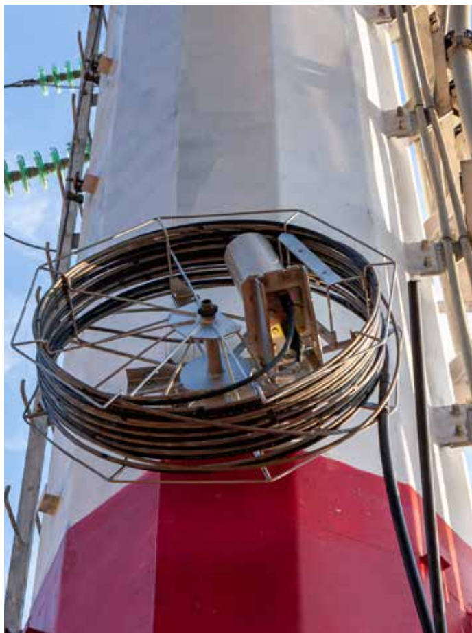
Барабан запаса оптического кабеля на стволе многогранной опоры
