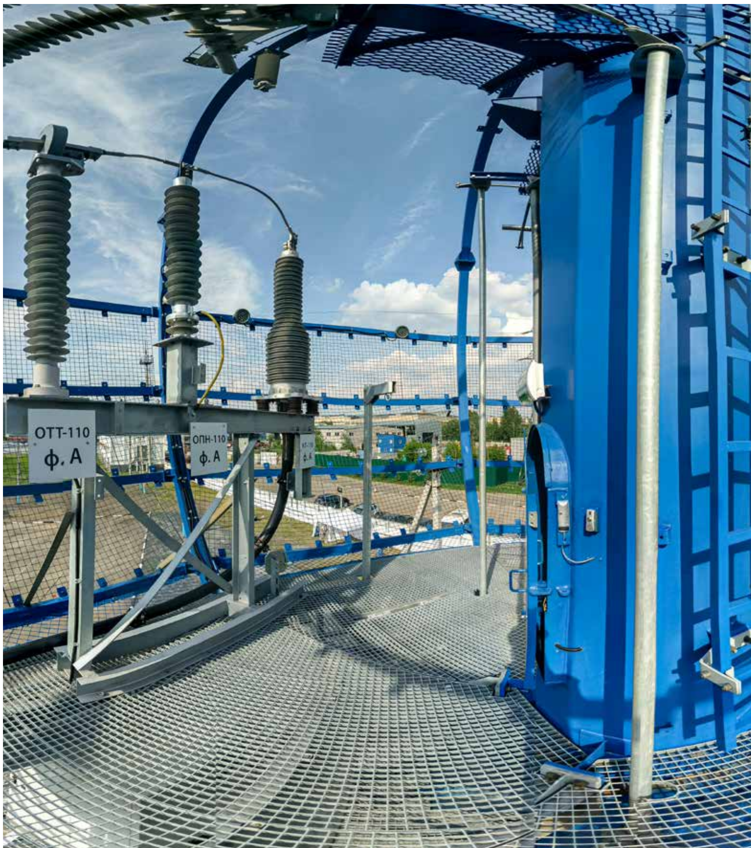
Верхняя эксплуатационная площадка ППМ: на стойке размещены сухая кабельная муфта, ОПН и электронный оптический трансформатор тока; вертикальные однофазные разъединители расположены на створе опоры
