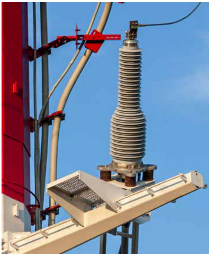
Площадка для обслуживания кабельной муфты и поручни вдоль траверс
