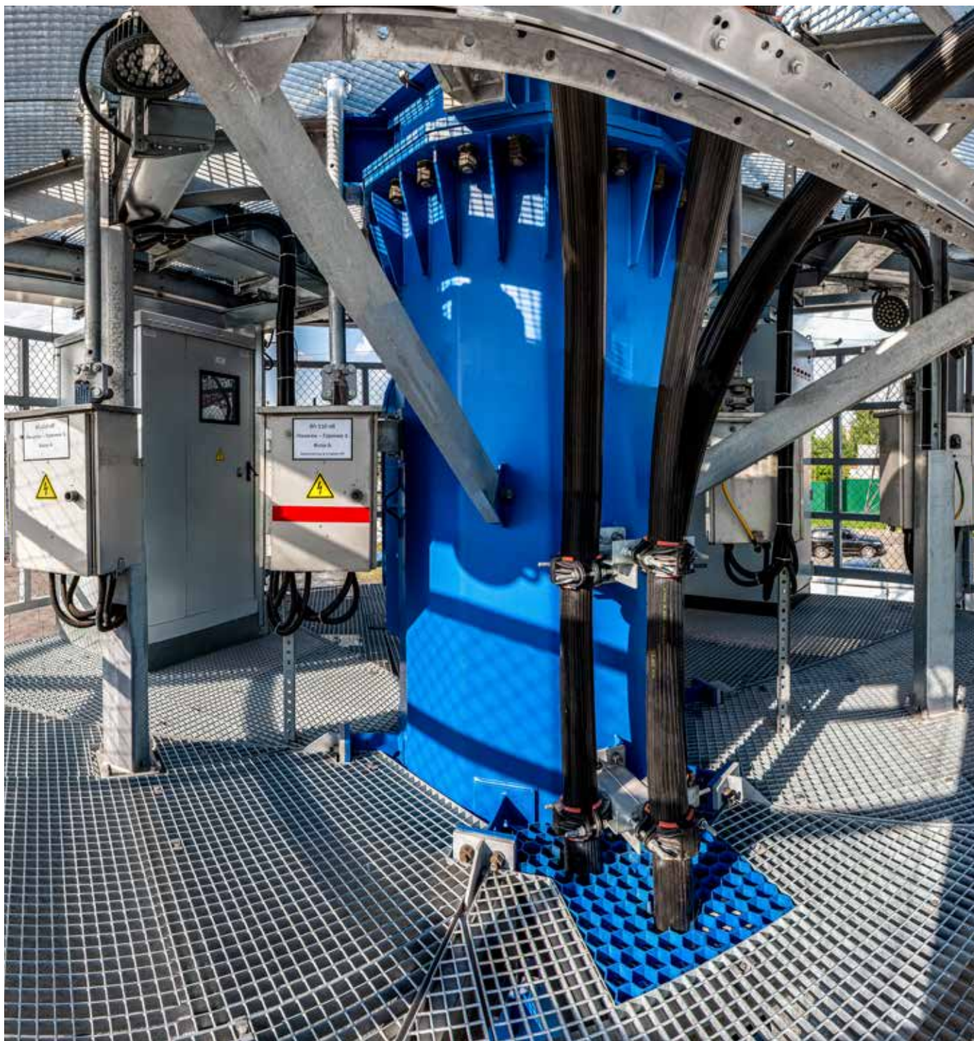
Нижняя эксплуатационная площадка ППМ: двигательные приводы разъединителя, климатический шкаф собственной АСУ ТП, климатический шкаф системы питания СН
